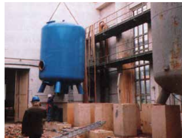
Neuer Wasserkessel für die Filterhalle des Wasserwerks Markwerben Wiese bei Weißenfels, 1999
