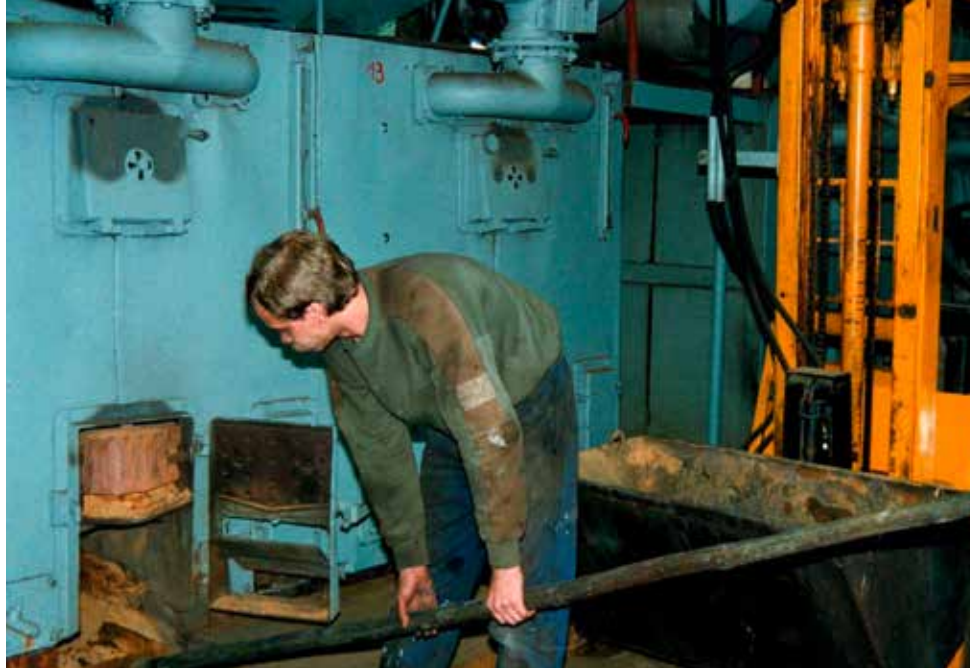
Heizhaus in Wittenberge vor Modernisierung, ca. 1991
